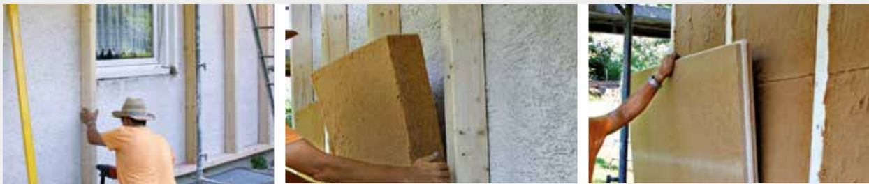
Wandsanierungsmöglichkeit von außen: PAVAFLEX zwischen Holzständer und vollflächiger Holzfaserdämmung ISOLAIR für WDVS oder Holzschalung.
