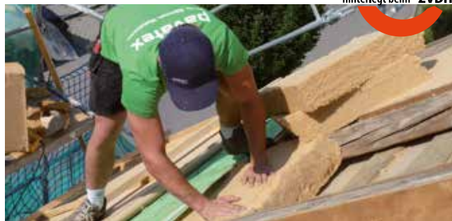
Die LDB-Sanierungsvariante ist technisch ausgereift und wirtschaftlich - Das Ergebnis nach der Sanierung ist ein diffusionsoffener Dachquerschnitt, der den gesamten Feuchtehaushalt in der Konstruktion regelt.
